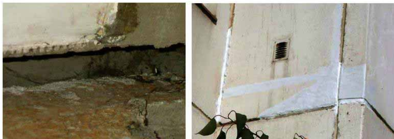
Slika 58. Pukotina ispod prozora i spoljna sanacija fasade (2004 godina)
