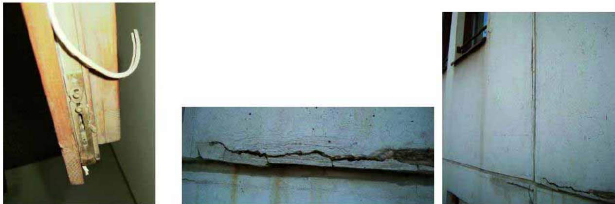
Slika 57. Spoljna oštećenja fasade i dotrajalost stolarije (2004 godina)
